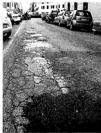
Rattoppi in via dei Volsci
