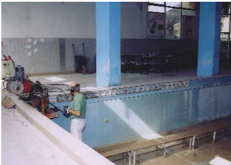
La speciale sega da parete, scorrevole sulla lunga guida fissata sulla struttura, durante il taglio orizzontale di 33 centimetri di profondità, all'interno della piscina
